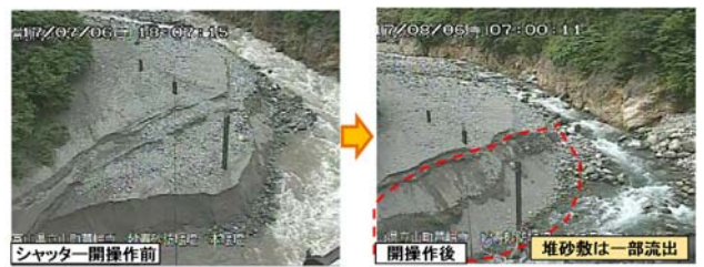
図-5 2017.7.4 出水(シャッター閉→水位 3.0m→開操作)
