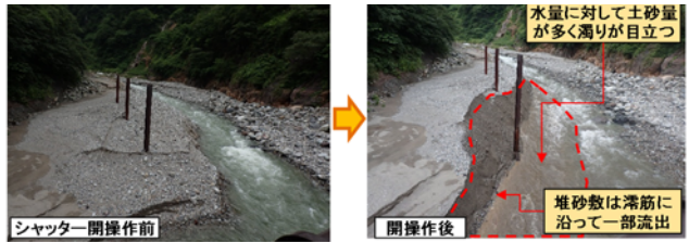
図-6 2016.7.27 出水(シャッター閉→水位 1.0m→開操作)
