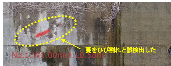
図1 ひび割れの誤検出事例(蔓をひび割れと誤検出)
