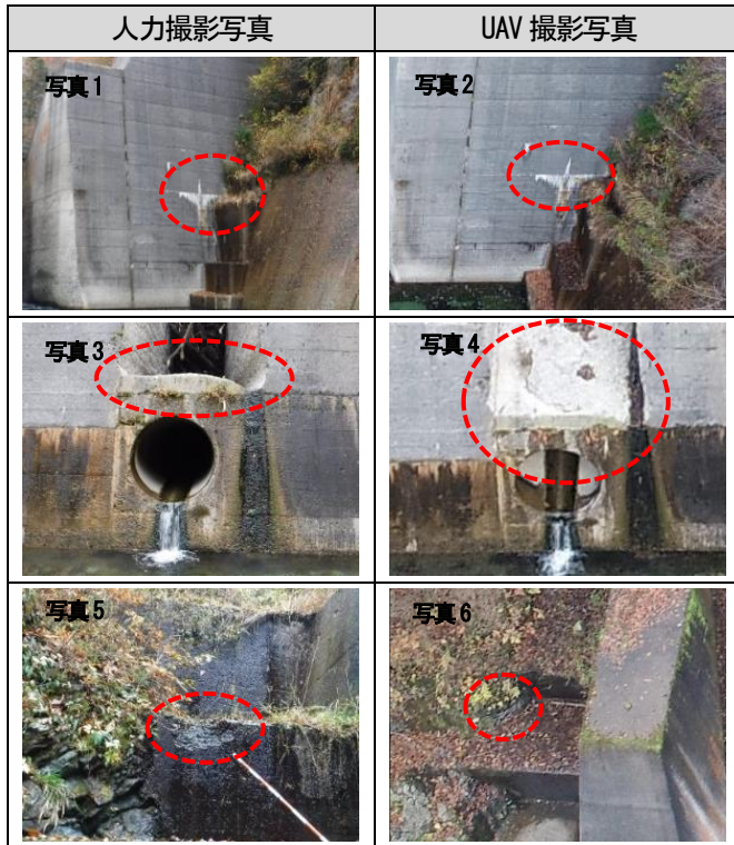
図-3 人と UAV との変状撮影写真の比較例
