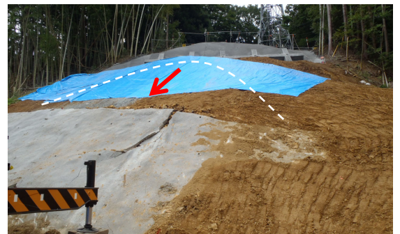
写-1 1ヶ月の露頭期間で崩れ始めた事例
