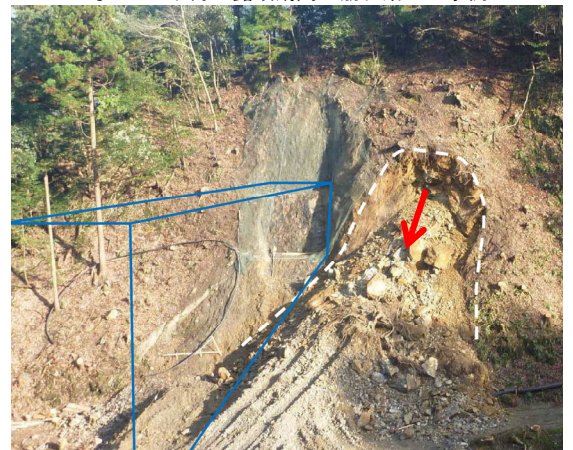
写-2 床掘り後に切土面端部から崩れた事例
