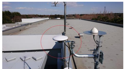
図-2 基地局のアンテナの設置状況
