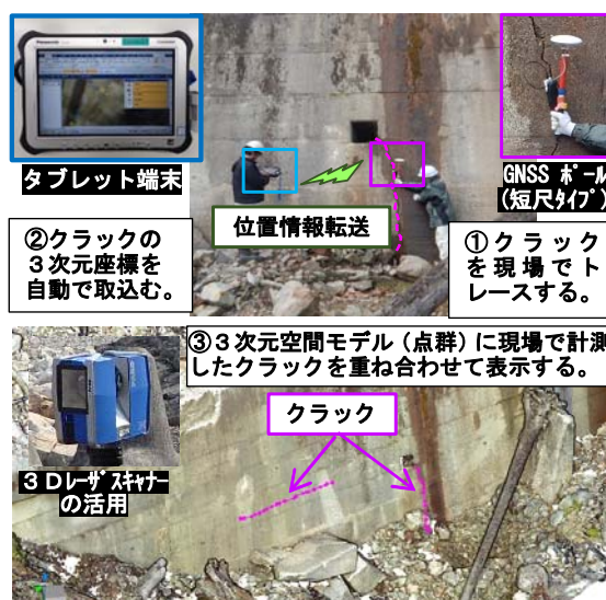
図-4 GNSS ポール(短尺)を使ったクラック調査の事例(ケース3)
