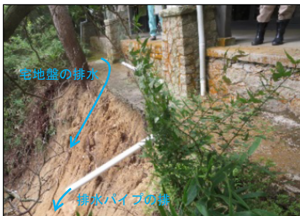
図 4 崩壊事例②（宅地下部斜面の崩壊）
