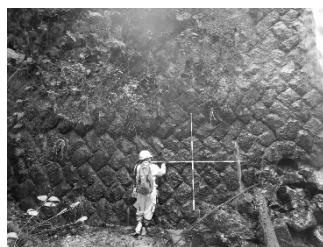
写真-2 孕みだしの状況
