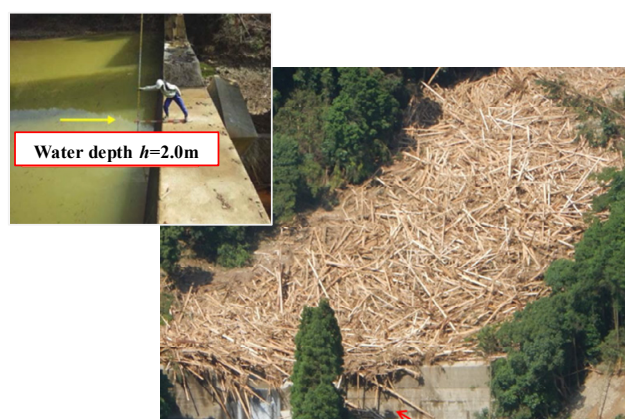
図-1 顕著に流木を捕捉した不透過型砂防堰堤の事例 1) に一部加筆
