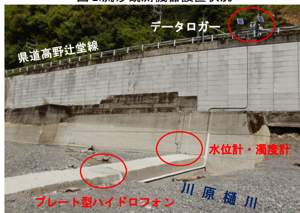
図3.流砂観測機器設置状況（合流点下流側）
