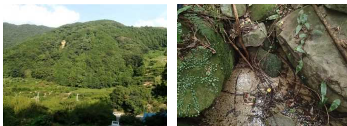
図-2 左図：岩盤クリープ（図-1中①から撮影）右図：岩盤クリープ斜面基部から湧出する湧水
