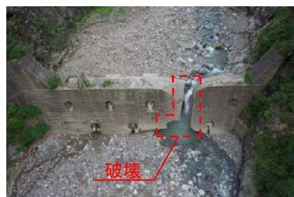
写-2 中ノ川下流砂防堰堤 破損状況
