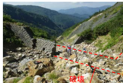
写-1 甚之助谷上流第17号砂防堰堤 破損状況
