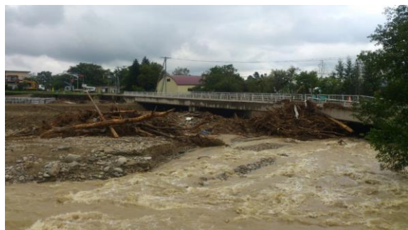
写真-1 清水町石山橋の閉塞状況
