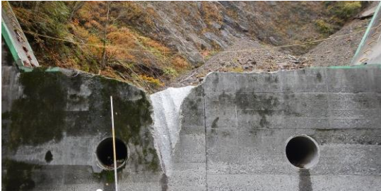
写真- 2 既設堰堤の摩耗事例
