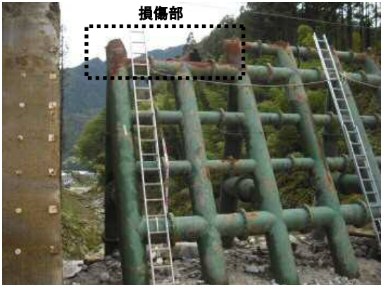
写真-1 上方部の損傷状況（左岸側）
