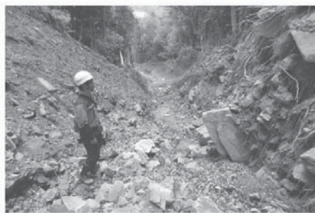
写真 B. 崩壊中腹部 (岩主体)
