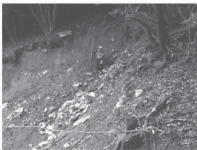
写真 A. 崩壊頭部 (砂主体)
