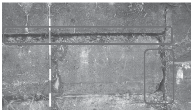
写真-3 施工環境に起因するとみられる打継目の開口
