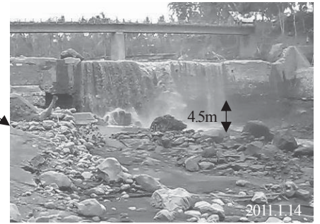
図 7 本堤前面の河床が 4.5m 低下した.
