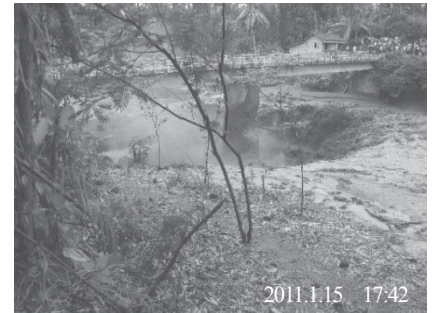
図 10 堆砂流失がさらに進行した.
