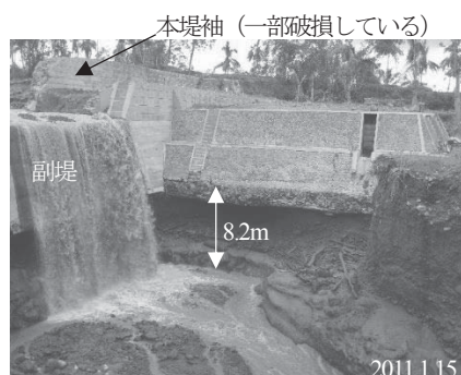
図2 SE-C2 副堤前面の河床が8.2m低下した。
