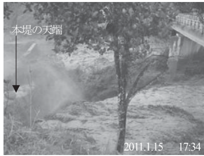
図 9 本堤基礎地盤が底抜けして堆砂が流失
