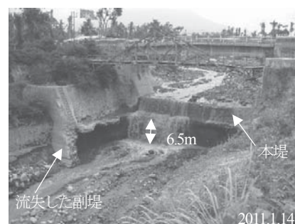
図4 SE-C1では本堤が堆砂を保持している。この状況は2011年2月17日にも確認された。
