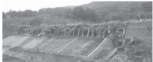
写真-1 伊豆大島における流木・土砂捕捉
