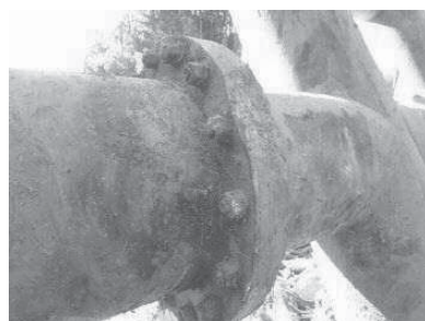
写真-9 フランジの状況
