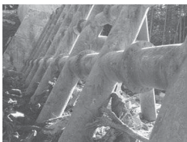
写真-8 捕捉面の状況
