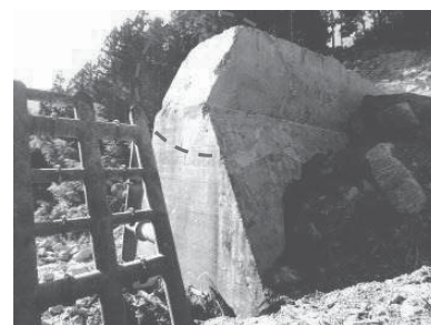
写真-10 袖部の摩耗状況
