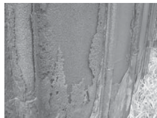
写真-3 剥離状の錆
