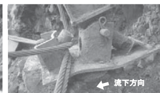
図 14 支柱基部変形状況
