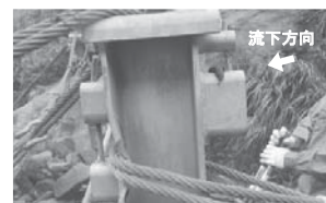
図 13 支柱頭部変形状況
