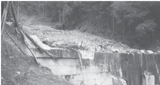
写真1 治山ダムにおける土石流の堆積状況
