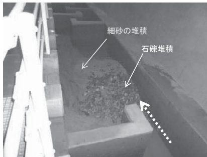
写真-4 魚道内の土砂堆積
