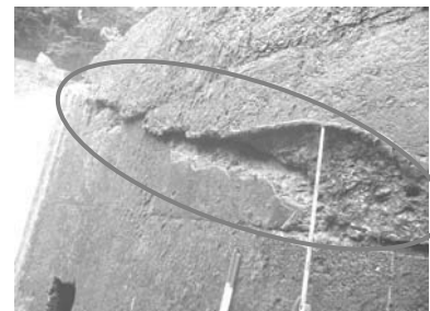
写真-3 ②堤体内部のたすき掛け状亀裂
