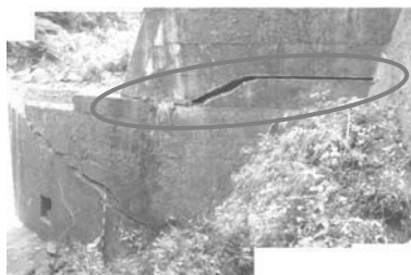
写真-2 ①袖部の押し出し亀裂
