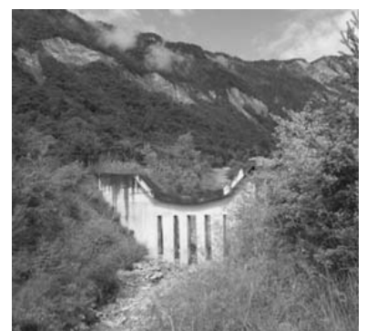
写真5 コンクリート製 透過型堆積工
