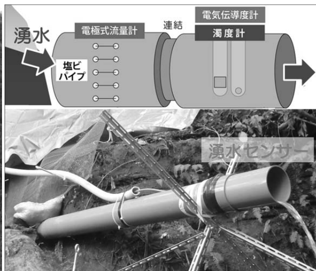
図3 湧水センサー（図2の■印地点に設置）
