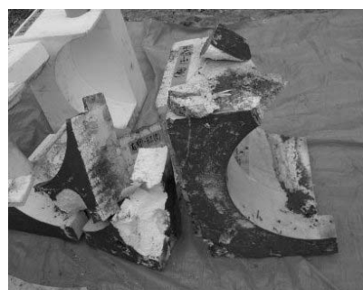
写真3 損傷した充填材（扇沢）
