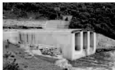
写真-1 底面水抜きスクリーン
