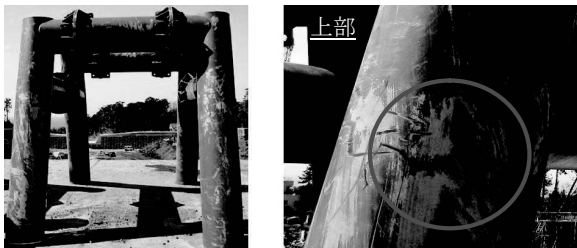
写真-4 上流側柱材損傷状況
