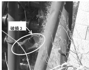
写真3 破損3 (水平梁の破損)
