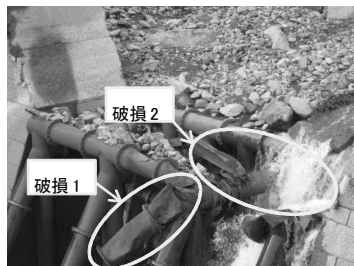
写真2 破損1, 2 (横梁・H形鋼の破損)
