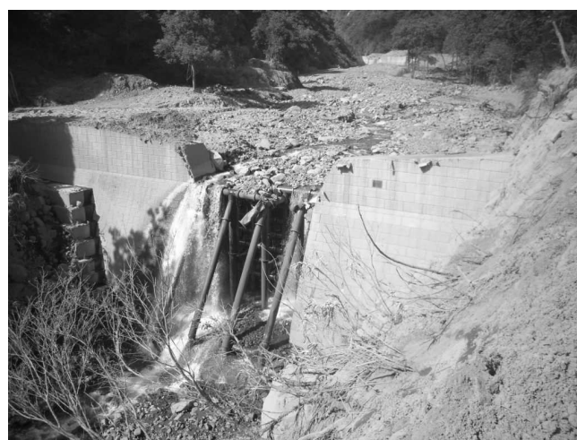
写真2 土石流捕捉後の格子形堰堤
