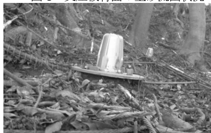
図7 支圧板背面の土砂流出状況
