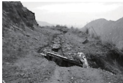
写真 1. 土砂の流出・風化侵食などの崩壊の様子
