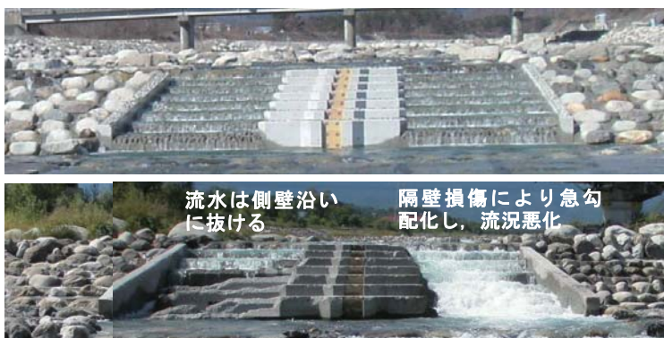
写真－１ 隔壁損傷状況（第 49 号床固工）
