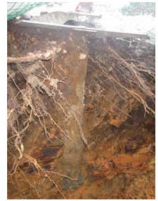
図 2-5 露出した補強材の状況 (補強材 No. 1)
