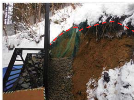
図 2-3 鋼製土留め枠工施工中の崩壊事例
