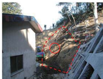
図 2-1 のり枠施工中の崩壊事例
