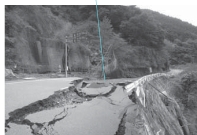
写真3. 国道の被災状況
