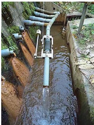
写真-5 集水管閉塞防止器の排水時の状況
