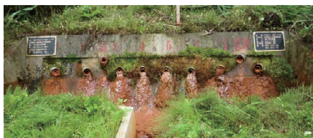
写真-1 横ボーリングの閉塞した集水管
