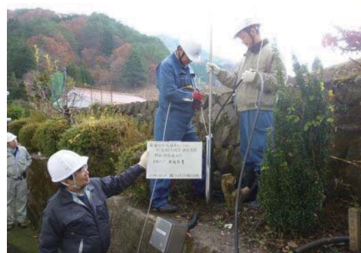
写真-2 観測局の振動センサー埋設状況 (設置深度 20m 程度)
