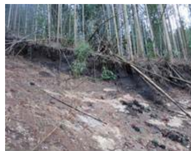
図-9 崩壊斜面源頭部の状況
