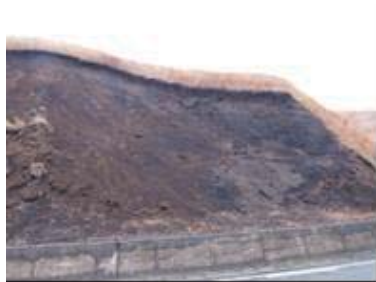
図-7 265号沿いの表層崩壊
