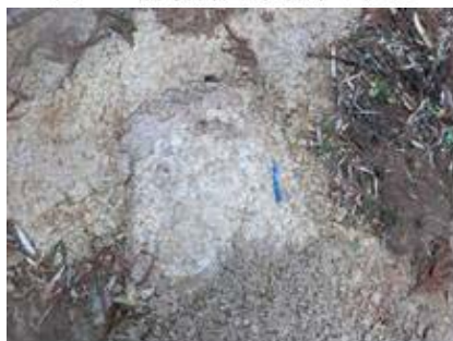
図-10 露頭しているすべり面の状況
