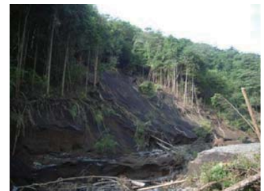
写真-2 上野川上流の崩壊地
