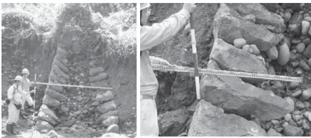
図-3 7号堰堤工(空石積)袖部の断面形状と前法の石材 (平成23年7月豪雨で被災・流出)
