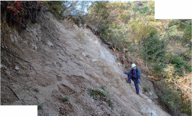
図-1 現地調査で確認した表層崩壊
