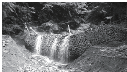
写真-5 流出土砂の捕捉状況（木挽崩沢）
