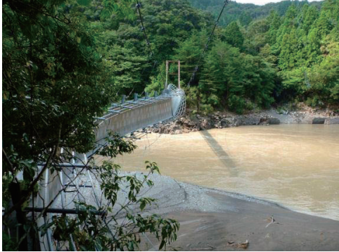
写真－1 吊り橋の損傷
