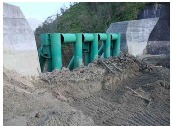
写真3 除石作業中の鋼製スリットえん堤で見られた流木と細粒土砂中心の土石流堆積物 (山口県防府市八幡谷川)
