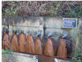
写真-1 集水管の閉塞事例
