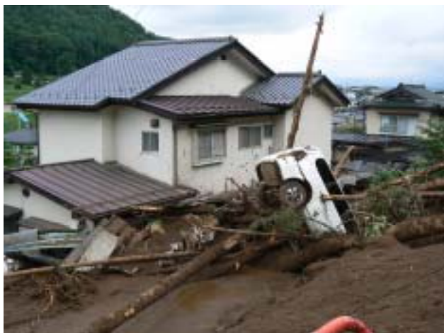
人家を襲った沢底川右支川の土石流（辰野町）
