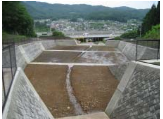
完成した土石流堆積工 (志平川)
