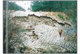
写真-1 地震(兵庫県被災例) 2)
