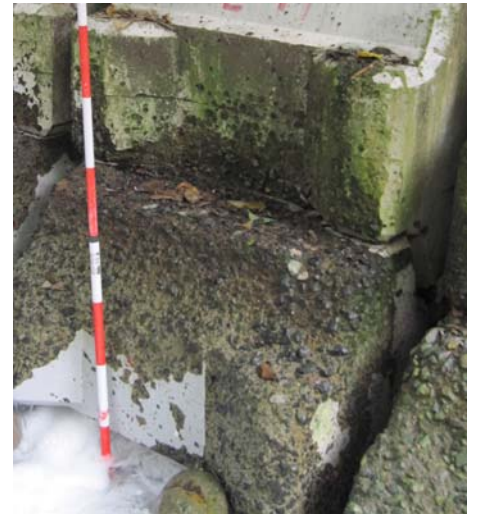
写真 1 酢川における護床ブロックの腐食状況
