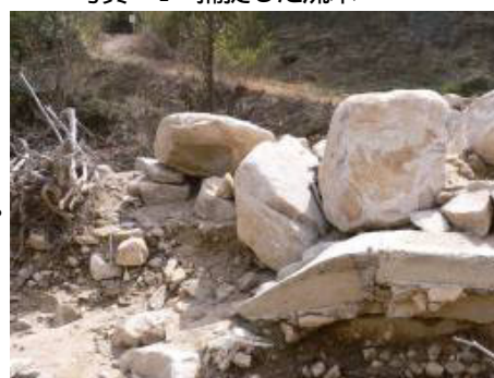
写真 5 上流側に堆積した礫群の状況
